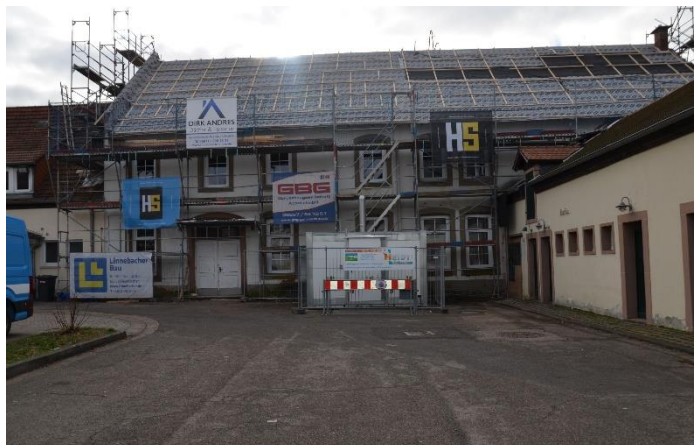
Frontansicht des Gebäudes mit der aufgestellten Bauheizung
