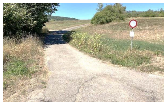
Belagschäden mit Sanierungsbedarf und durch Schranke behinderte Durchfahrt
